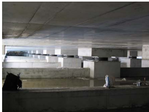
FIG. 8. Isolatori sismici installati.
