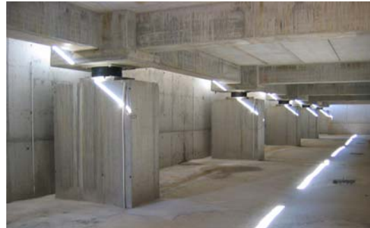
FIG. 2. Isolatori installati nell'Ospedale di Udine.
